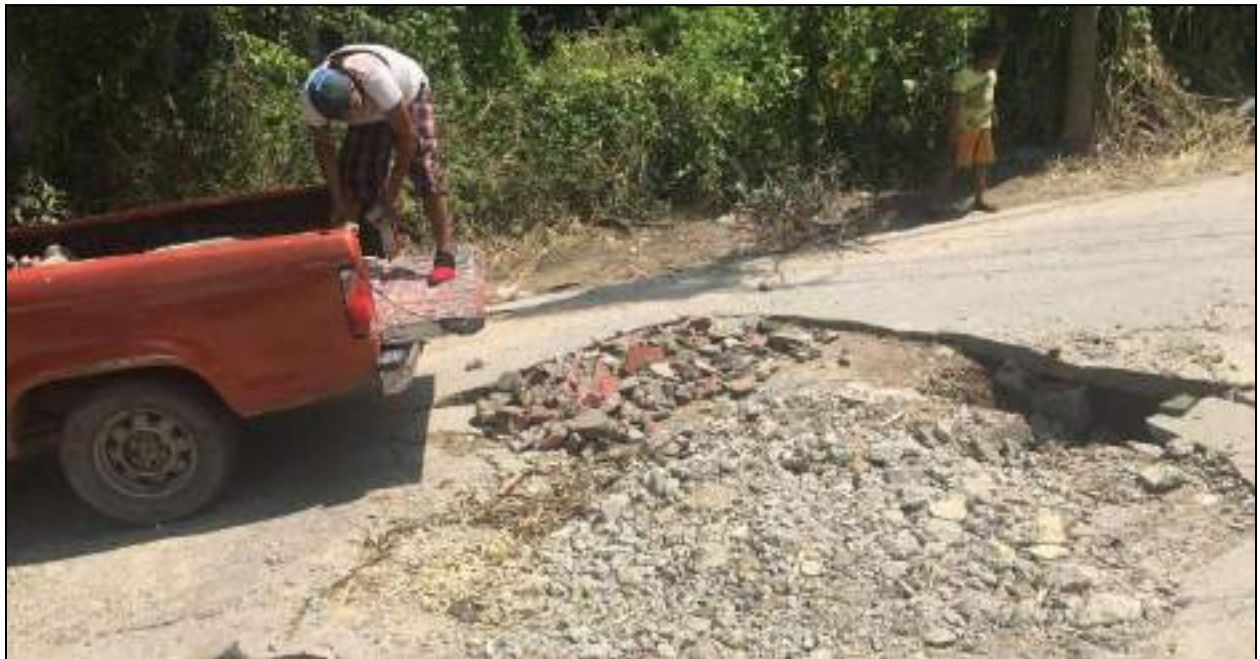
Figura 11. Socavón en la calle Benito Juárez
